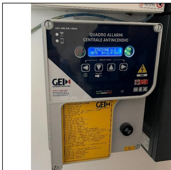
Pannello ripetizione allarmi UNI 12845 Stazione idrica antincendio
