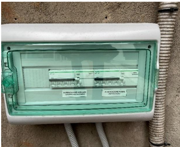
Quadro alimentazione di potenza e ausiliari Stazione idrica antincendio
