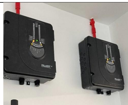
CENTRALINE IMPIANTO ASD
