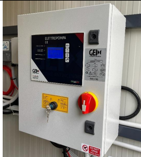
Quadro di bordo stazione pressurizzazione Impianto idrico antincendio
